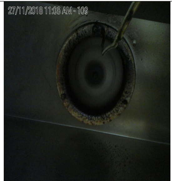
Fotografía No. 4 Sistema de extracción.
